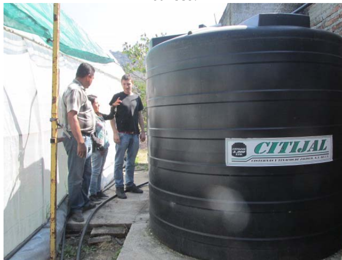
Imagen 43. Tinaco para almacenar agua de lluvia filtrada con piedra volcánica en Rancho Viejo, Jalisco.
